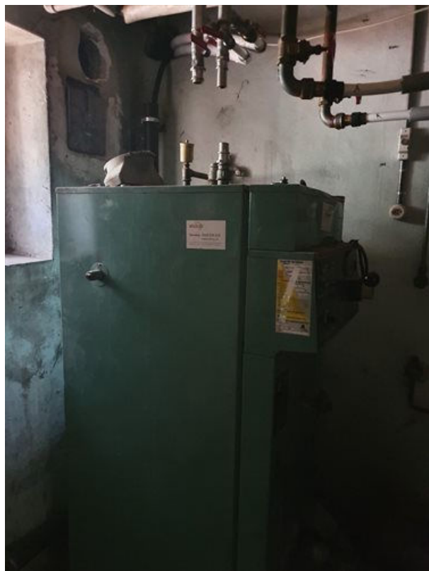
Première chaudière de 1973
